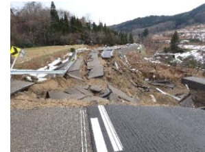
崩落した国道359号（小矢部市）
