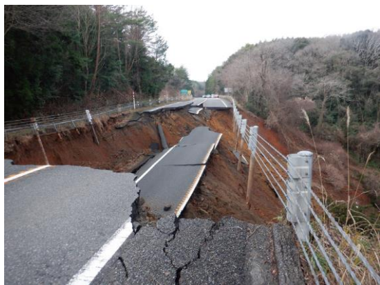
道路崩壊（のと里山海道）
