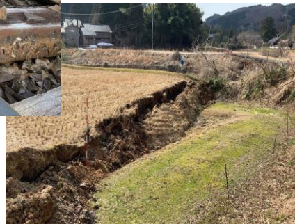
農地の地割れ（珠洲市）
