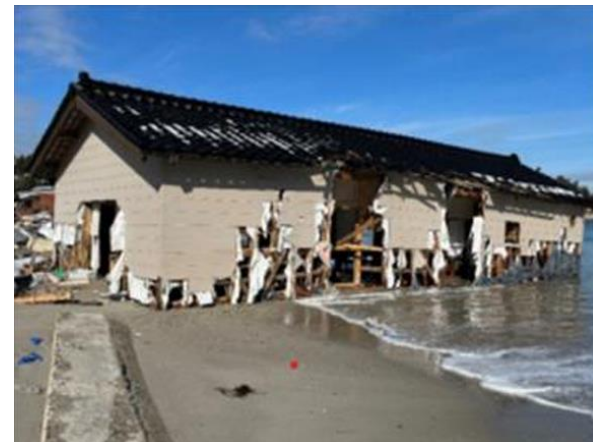
津波の引き波による被害（能登町）
