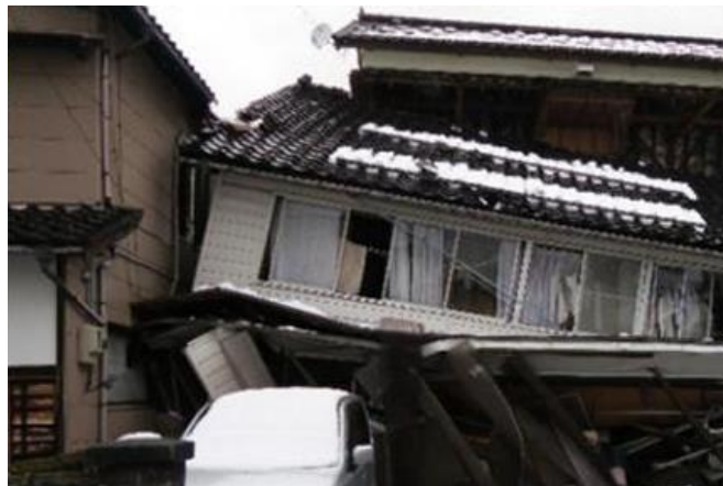
木造建築物の倒壊状況（穴水町）
