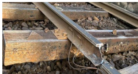
レール損傷 （のと鉄道穴水駅）
