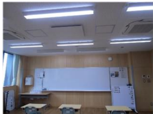
普通教室の空調室内機とLED
