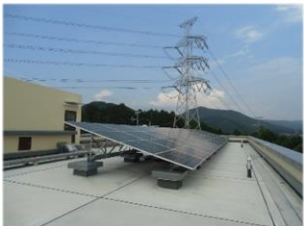
太陽光発電設備
