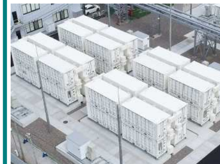
系統用蓄電池 ※民間 (2025年運転開始予定)
